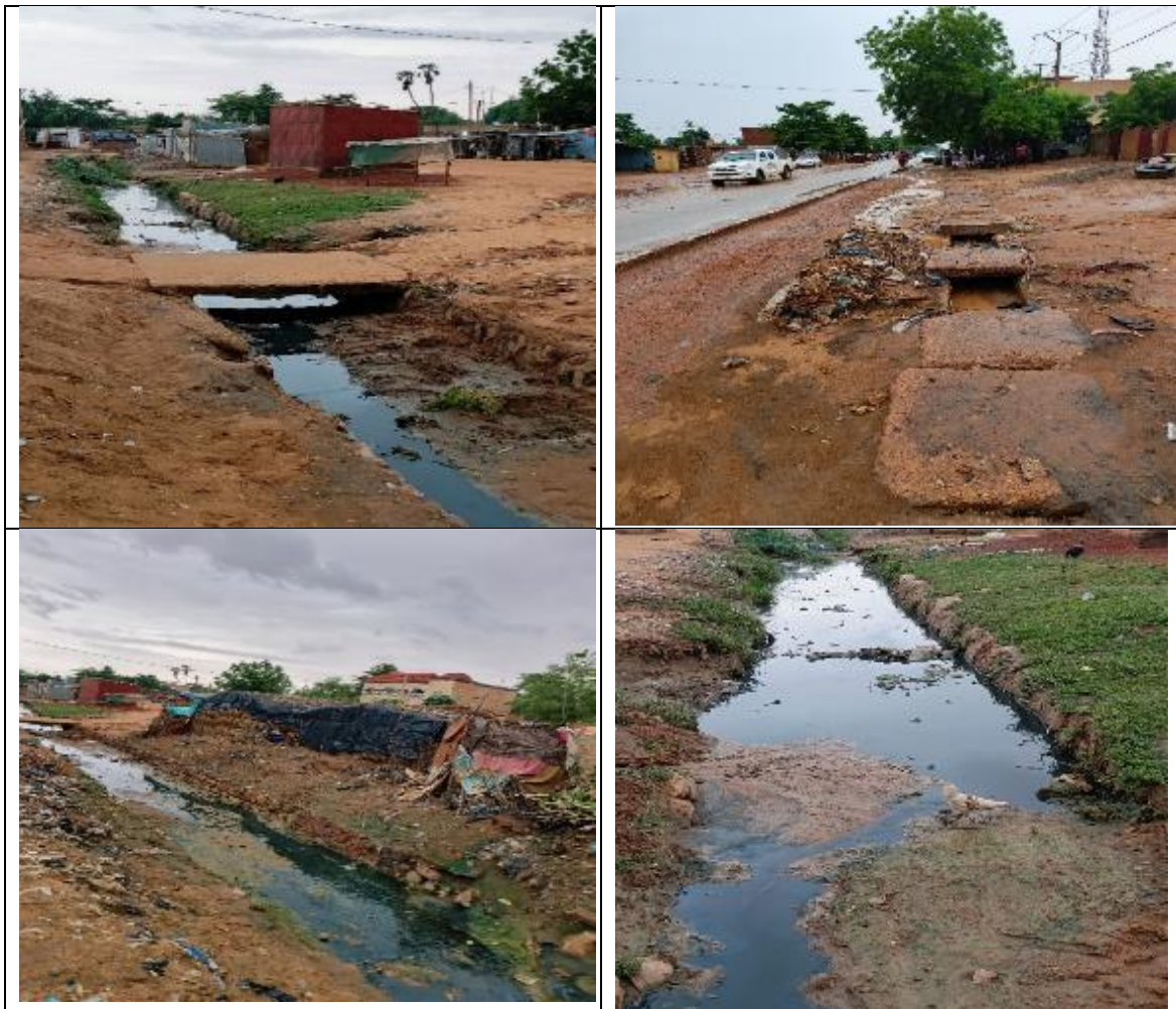
Planche 12. Stagnation des eaux dans des caniveaux dans la zone du sous-projet
